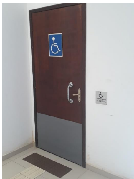
Figuras 30 e 31: Sinalização de Banheiro Acessível - IM
