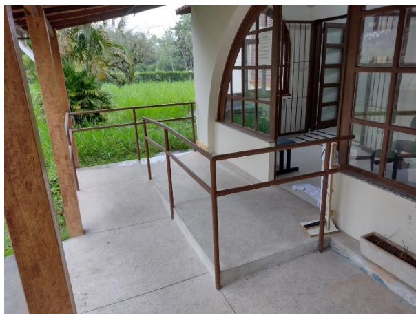
Figura 25: Rampa de acesso ao prédio da CASST (Coordenação de Atenção à Saúde e Segurança do Trabalho) - Campus Seropédica
