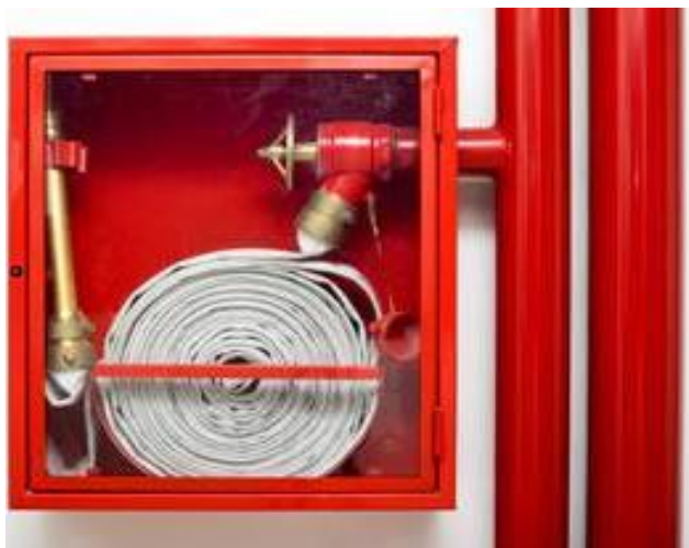
Figura 25 - Hidrante na parede.
